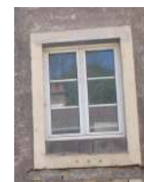
PVC Battée trop épaisse
